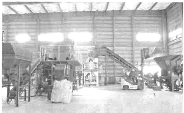
稼働する破碎選別設備
